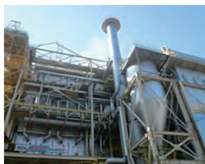
木質系バイオマス (住友大阪セメント㈱栃木工場)
