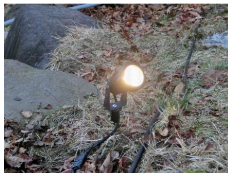
図-7 スポットライトの設置
