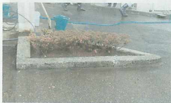
図-7修繕前の正面玄関の花壇
