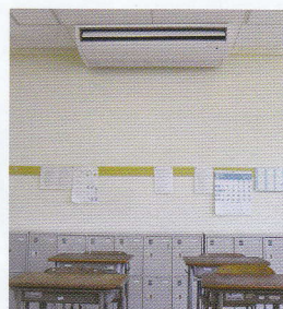
教室に設置されたエアコン
