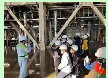
発電設備の見学
