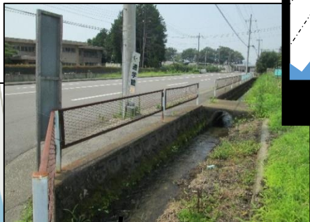
冠水（境界不明による転落）
