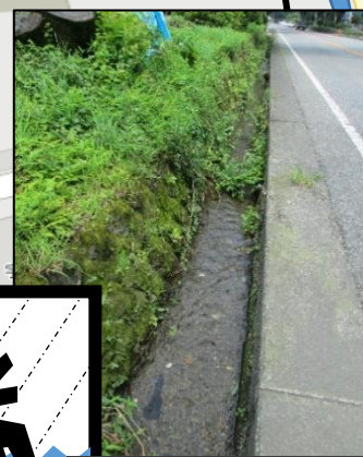
冠水（境界不明による転落）
