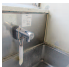
廊下手洗い場の自動水栓
